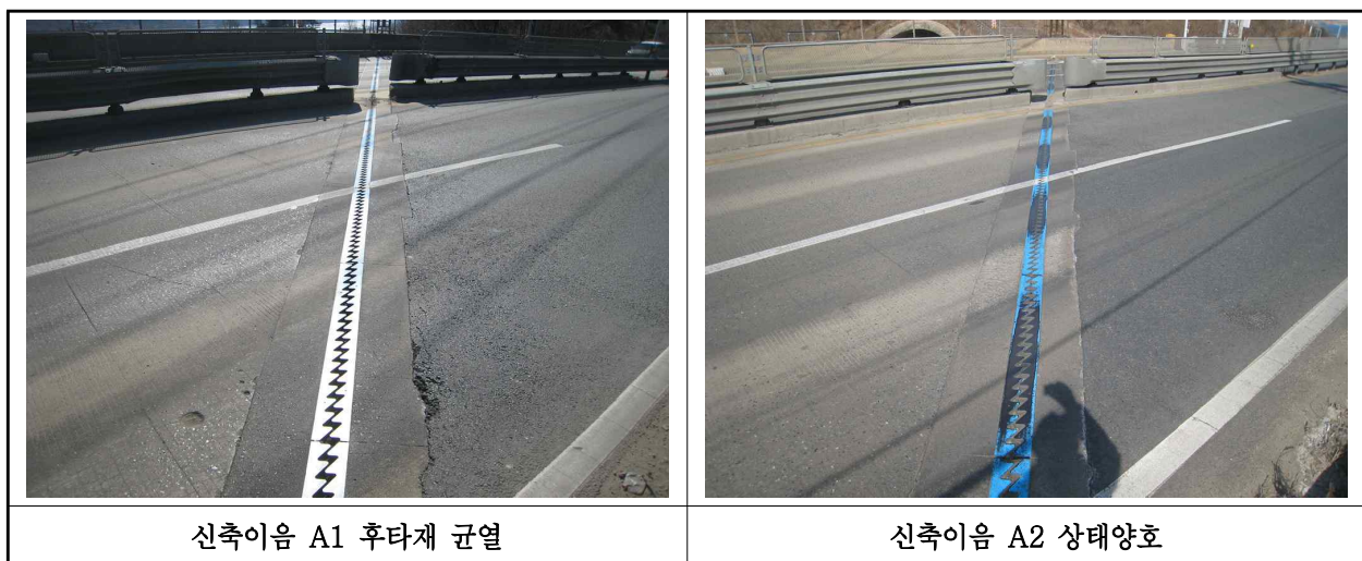
【사진 5.3.15】 신축이음장치 손상현황
