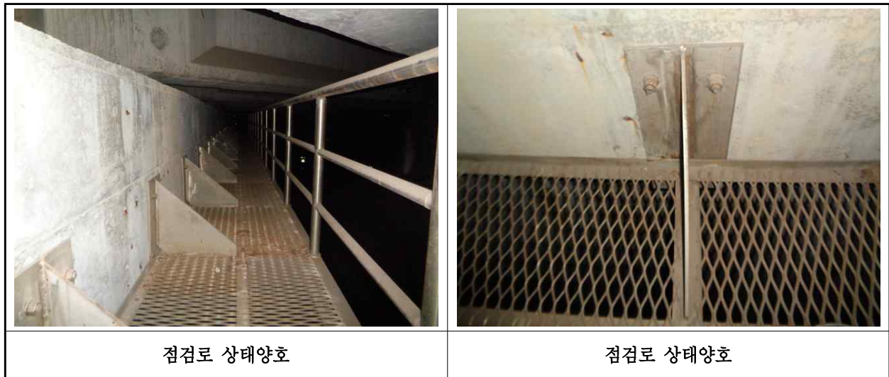
【사진 40.3.24】 교량 점검시설 손상현황
