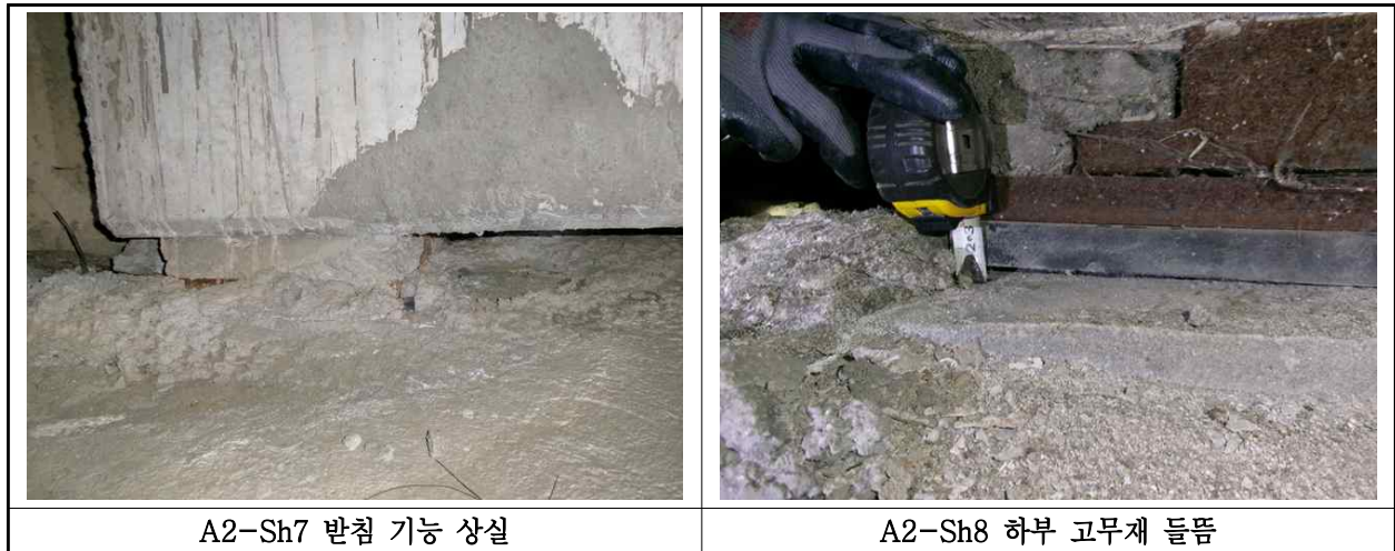
【사진 5.3.11】 교량받침 손상현황 - 계속
